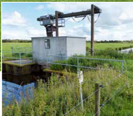
Das Schöpfwerk pumpt Wasser aus den Entwässerungsgräben in die Eider.
